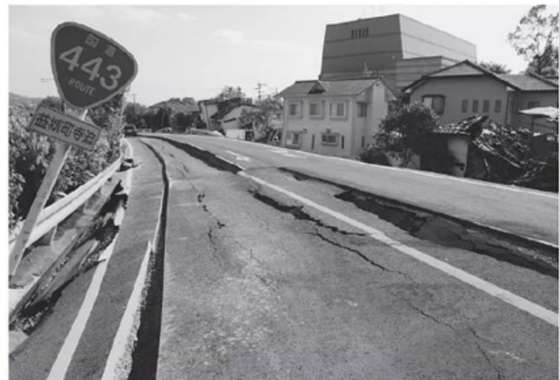
益城町の国道443号線はセンターラインに大きな段差ができていた。道の端は崩れ落ち、付近の多くの家屋も倒壊していた。ここは断層でズレたのか?
